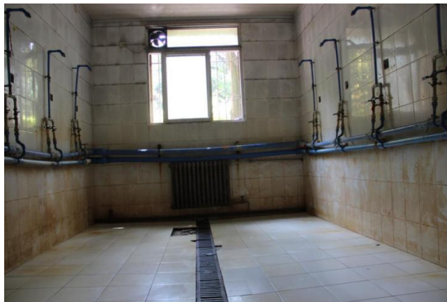
学生男女浴室维修前照片
